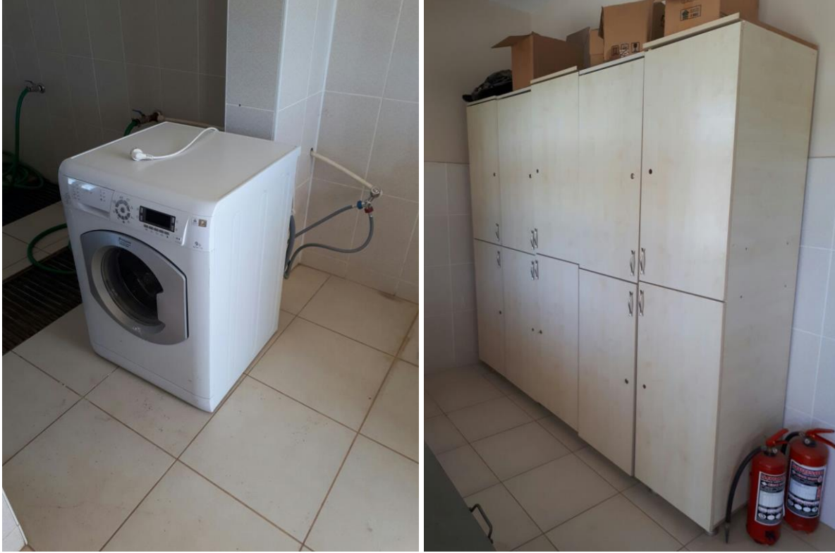
Resim 2. Tıbbi Atık Sterilizasyon Ünitesinde Kullanılan Çamaşır Makinesi ve Kıyafet Dolapları
